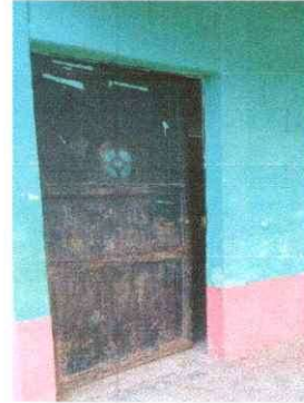
Foto 2: Se evidencia el mal estado en que se encuentra las puertas del establecimiento.
