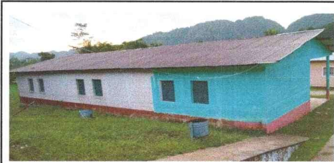
Foto1: En la imagen se logra apreciar el deterioro de las láminas del establecimiento.
