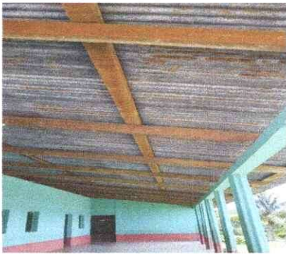
Foto 3: Se evidencia las tijeras y costaneras de madera que se sustituirá por metal.
